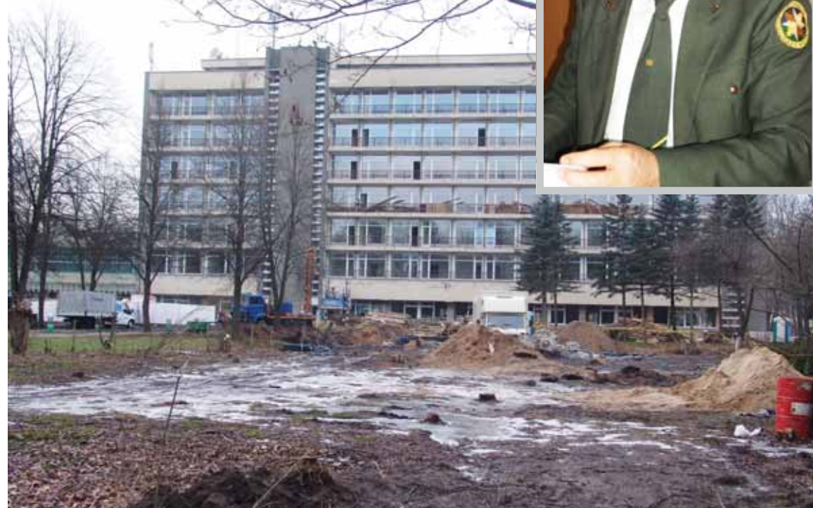
„Lietuvos sanatorijos“ teritorijoje montuojama geoterminio šildymo sistema. „Teršalų išmetimo, šildant pastatus, šiuo atveju nėra“, - teigia Alytaus regiono aplinkos apsaugos departamento direktorius Česlovas Meržvinskas
